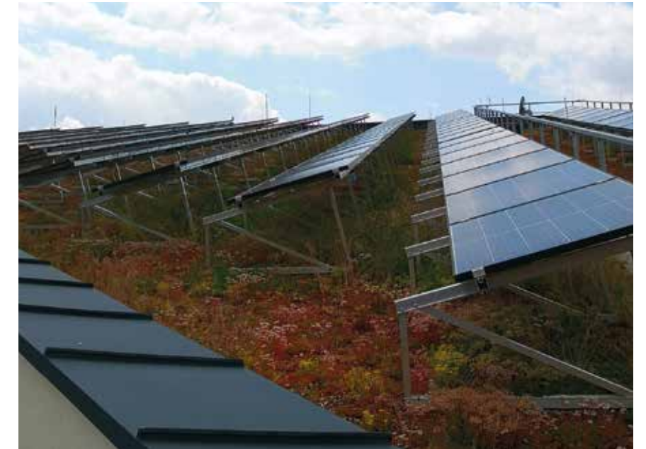
Gründach und Fotovoltaik - eine Kombination mit Mehrwert
